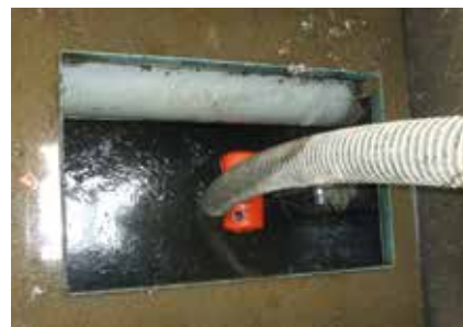
Vista de la cámara del separador
