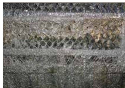
Detalle de un filtro coalescente muy cargado de lodos y que requiere una intervención.
