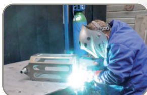
Une Chaudronnerie Industrielle
