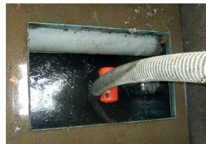
Vue de la chambre séparateur
