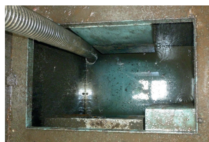
Vidange de la chambre séparateur
