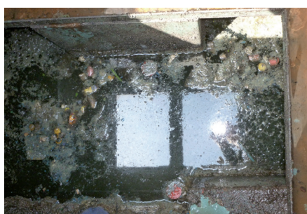
Vue de la chambre débourbeur
