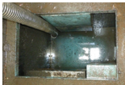
Vidange de la chambre séparateur
