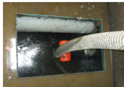
Vue de la chambre séparateur
