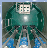
Canalisations inox à l'intérieur de la cuve
