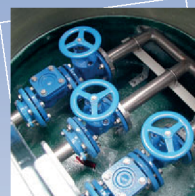
Canalisation inox dans regard de vannage
