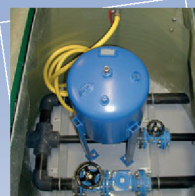
Réservoir anti-bélier dans regard de vannage
