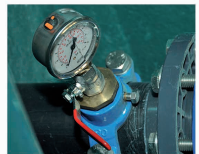
Prises manométriques sur chaque canalisation de refoulement
