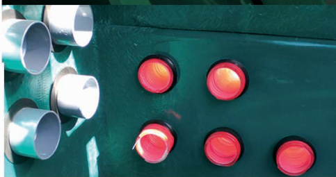
Accès à la totalité du cablage par le regard de vannage pour faciliter le raccordement des cables
