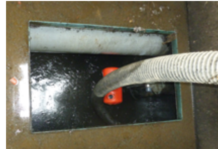
Vue de la chambre séparateur
