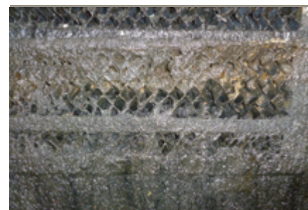
Détail d'un filtre coalesceur fortement chargé en boues et nécessitant intervention
