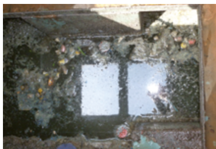
Vue de la chambre débourbeur
