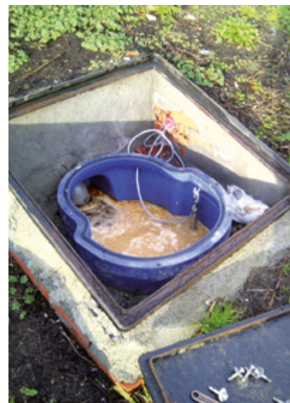
Exemple d'un séparateur de graisses devant être vidangé
